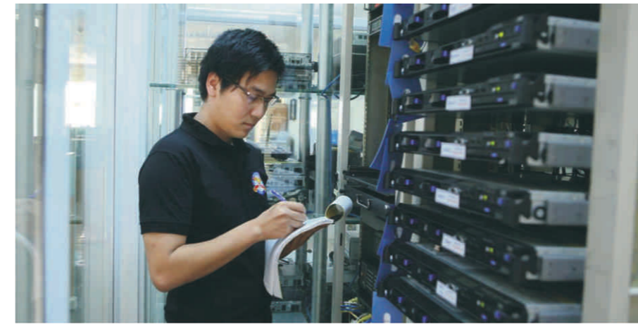
BkavCA trang bị hệ thống Data Center tiêu chuẩn quốc tế.
